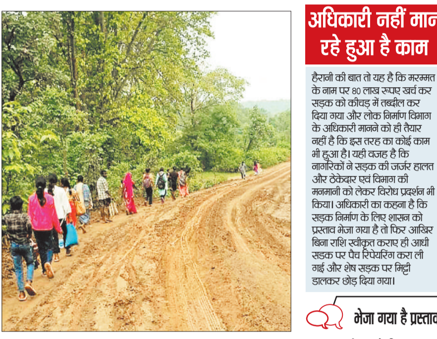
मेजा गया है प्रस्ताव सड़क डामरीकरण के लिए प्रस्ताव बनाकर शासन को भेजा गया है। शासन से स्वीकृति मिलने के बाद काम कराया जाएगा। एसडीओ, सब इंजीनियर को भी जर्जर सड़क का निरीक्षण करने के लिए भेजा गया है। -मोहन राम भगत ईई
